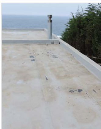
ANTES DE LA IMPERMEABILIZACIÓN
