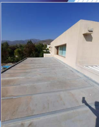
ANTES DE LA IMPERMEABILIZACIÓN
