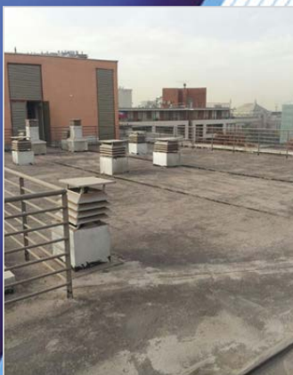
ANTES DE LA IMPERMEABILIZACIÓN
