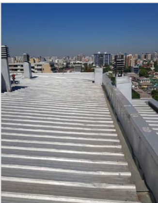
ANTES DE LA IMPERMEABILIZACIÓN
