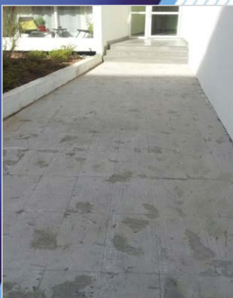
ANTES DE LA IMPERMEABILIZACIÓN
