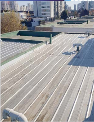
ANTES DE LA IMPERMEABILIZACIÓN
