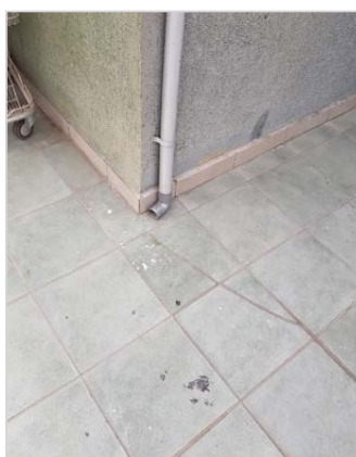
ANTES DE LA IMPERMEABILIZACIÓN
