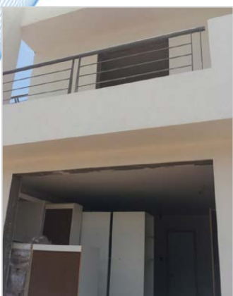
ANTES DE LA IMPERMEABILIZACIÓN
