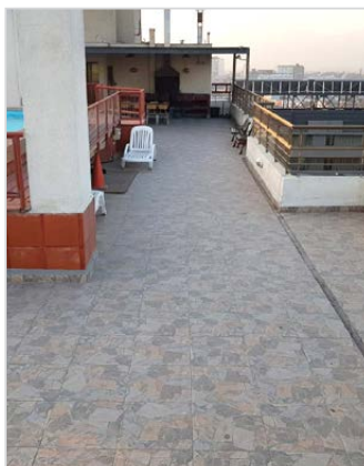
ANTES DE LA IMPERMEABILIZACIÓN
