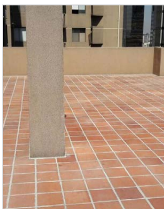
ANTES DE LA IMPERMEABILIZACIÓN
