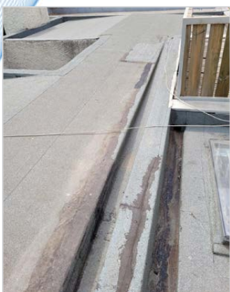
ANTES DE LA IMPERMEABILIZACIÓN
