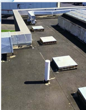
ANTES DE LA IMPERMEABILIZACIÓN
