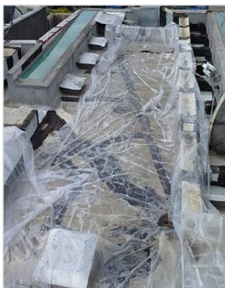
ANTES DE LA IMPERMEABILIZACIÓN
