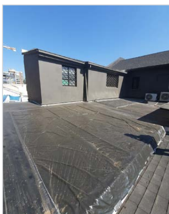
ANTES DE LA IMPERMEABILIZACIÓN
