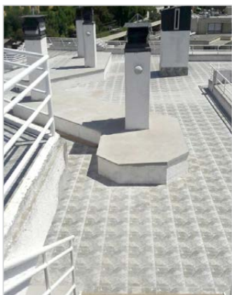
ANTES DE LA IMPERMEABILIZACIÓN
