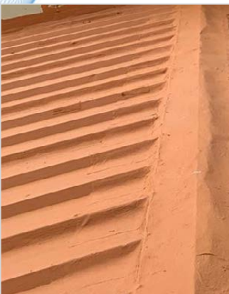
ANTES DE LA IMPERMEABILIZACIÓN
