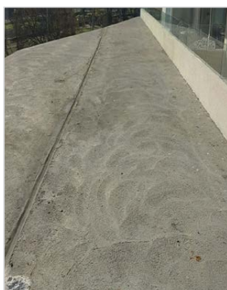
ANTES DE LA IMPERMEABILIZACIÓN
