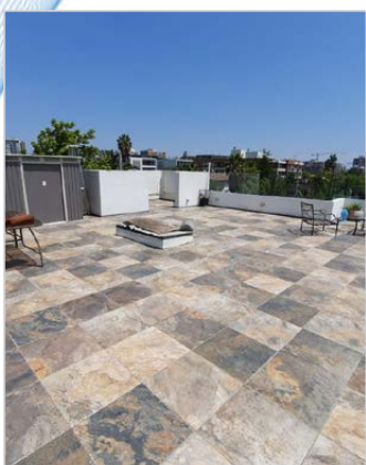
ANTES DE LA IMPERMEABILIZACIÓN
