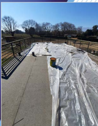
ANTES DE LA IMPERMEABILIZACIÓN
